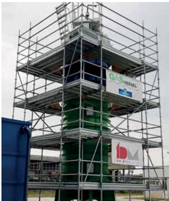
Impianto di idroformatura situato nel piazzale dello stabilimento aziendale di Buttrio
