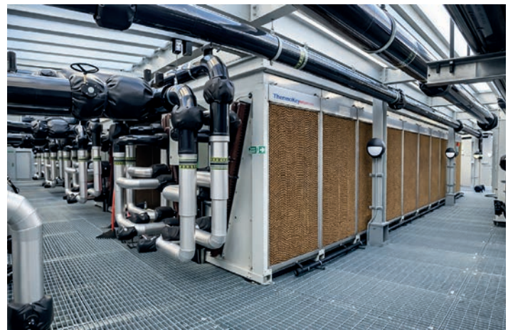
Drycoolers per il raffreddamento di un importante datacenter londinese
